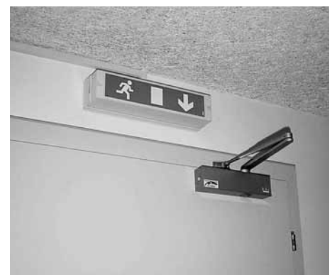
Bild 6: Beispiel einer Notbeleuchtung.
